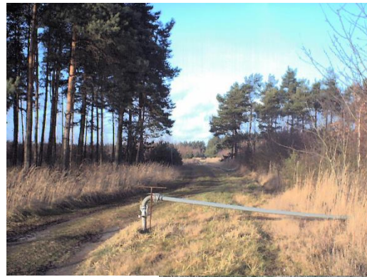
Abb. 6 - 9: Anlagen zur Versickerung von gereinigtem Abwasser (offen (Abb. 6 - 7) bzw. durch Tropfdüsen (Abb. 8 - 9); Fotos: LWK)
