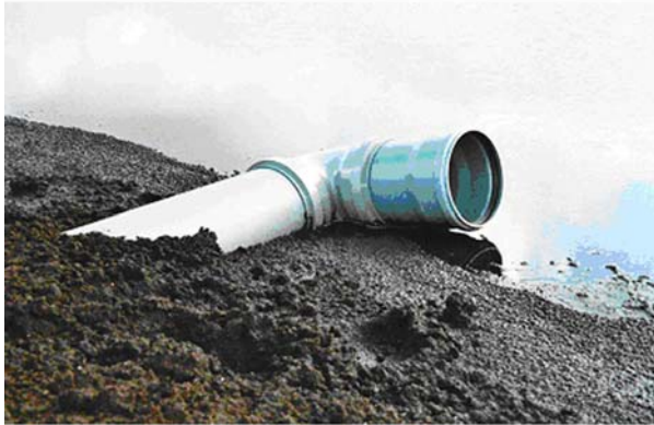
Abb. 8: Regelung der Wasserstände mit einem KG-Rohr und aufgesetztem Bogenrohr (J. Blankenburg)
