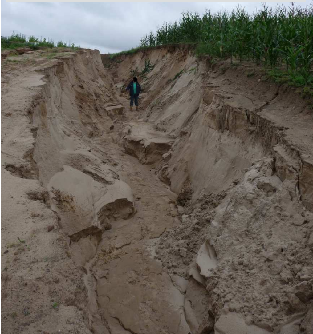
Erosionsgraben auf einer Baustraße © Ingenieurbüro Feldwisch
